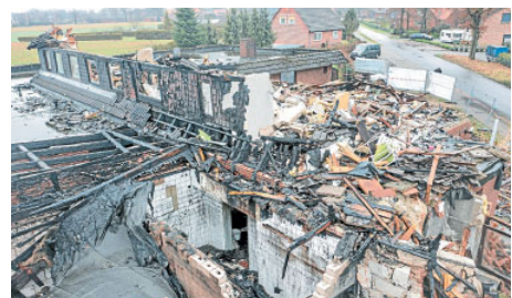
In der Nacht auf den 3. November 2023 brach in einem ehemaligen Seniorenheim, das zu einer Flüchtlingsunterkunft werden sollte, ein Feuer aus. Große Teile des Gebäudes wurden zerstört. Foto: t&w
